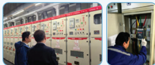
圖：配電室智能化改造
