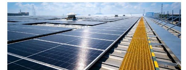
無錫惠山園區分佈式光伏
