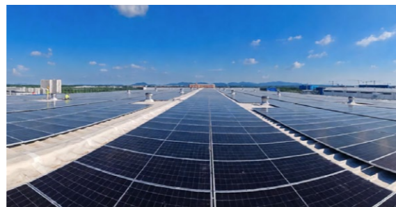
南京江寧園區分佈式光伏
