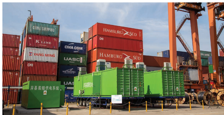
於和記港口鹽田國際的岸電系統
