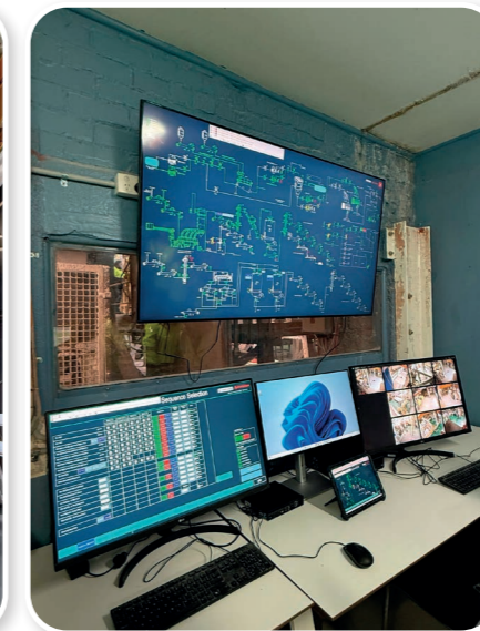
SCADA系統用以監測煉鹽過程
