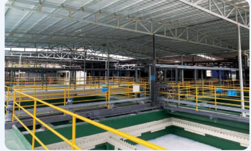
電鍍廢水處理現場
