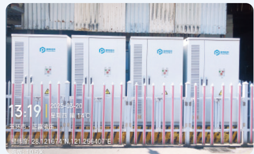
儲能系統設備
