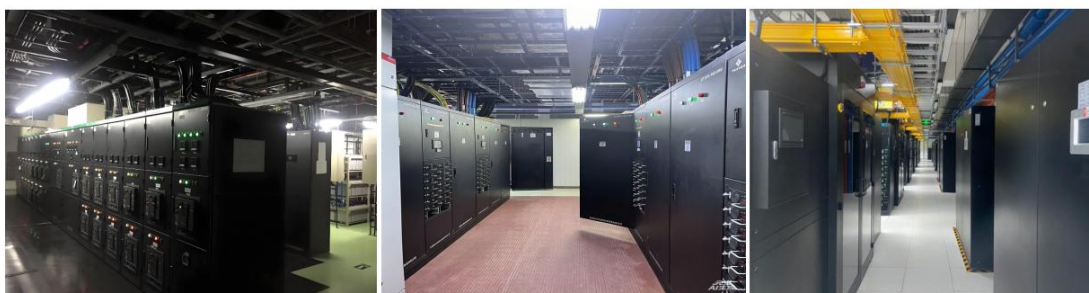
中国移动辽宁公司 2025 年低压 配电开关设备集中采购项目
