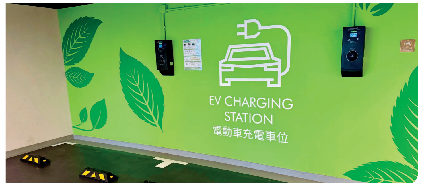
長江集團中心二期的停車場已安裝電動車充電設備，以推動可持續發展措施。
