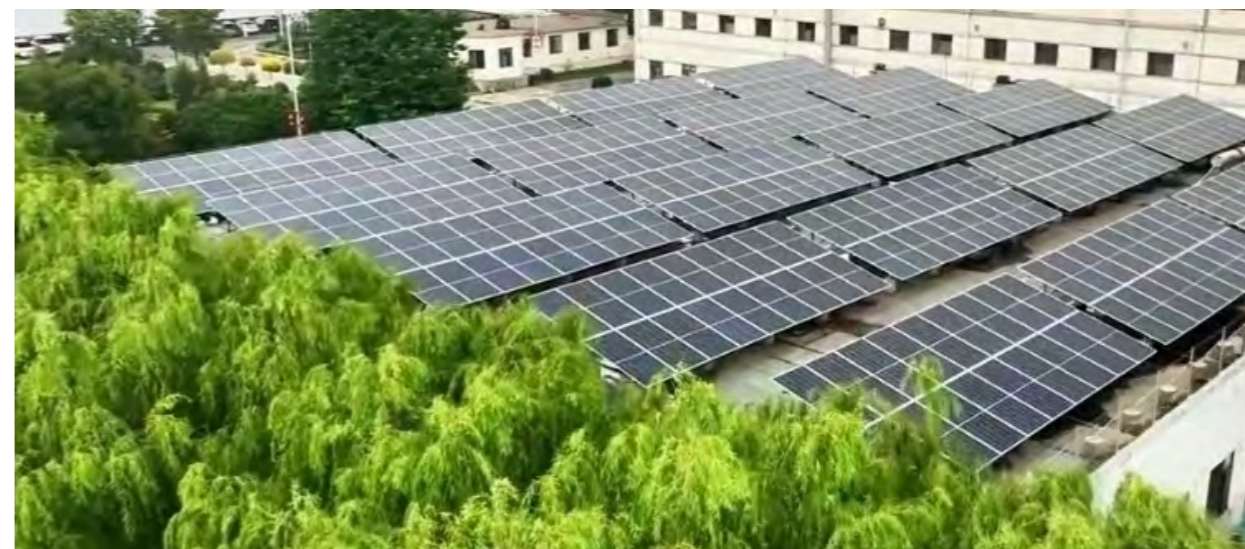
5.96 兆瓦分布式光伏电站
