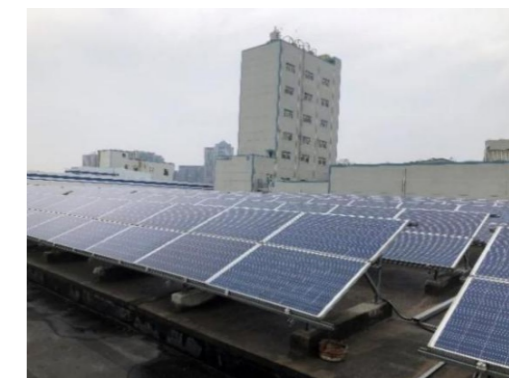
马桥厂区太阳能板
