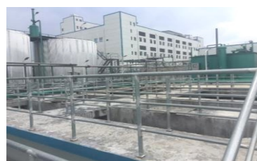
聚酯厂区污水处理站
