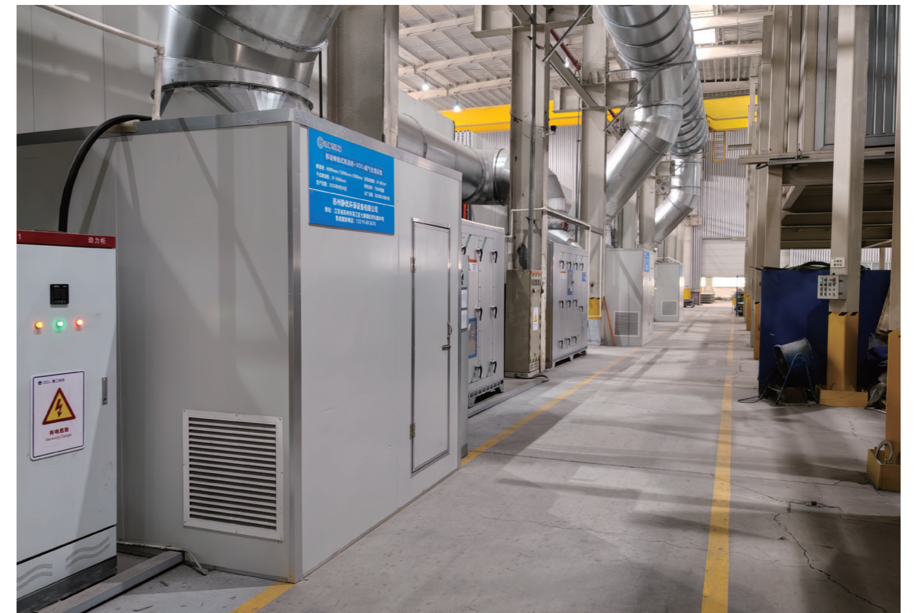
降噪控制设备：大型风机隔离室
