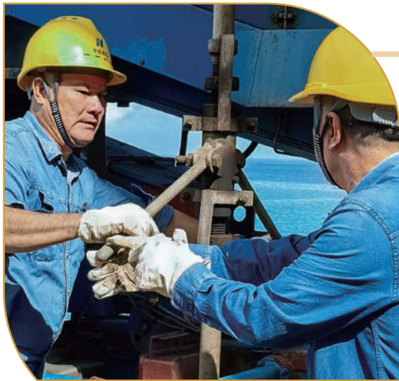
华能海南公司积极应对台风侵袭
