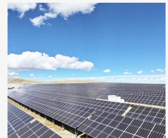
廉色尼区甘丹康桑 100 兆瓦光伏储能项目
