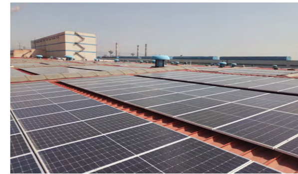
稀土钢冷轧板材厂光伏发电项目
