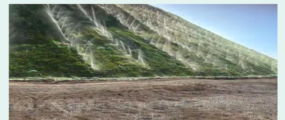
排土场边坡喷灌系统
