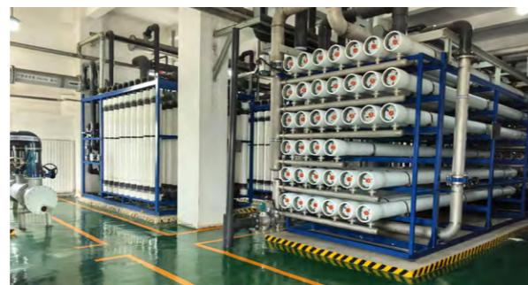
煤焦化工分公司开展酚氰废水深度处理回用项目
