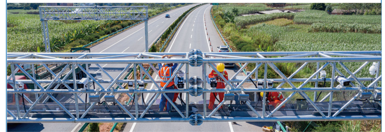
▲ 公司软件工程师进行ETC门架设备调试
