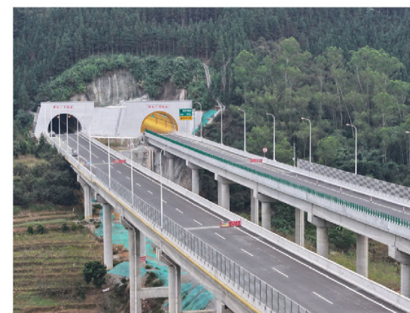
▲ 那坡枢纽互通过桥管箱 - 那平高速机电通信管道工程
