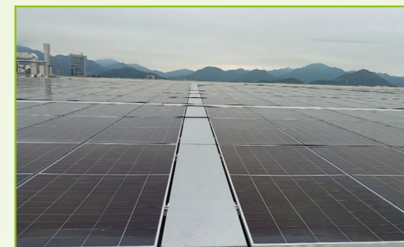
临海水晶 3.2MW
