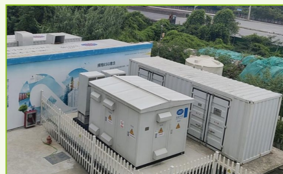
储能 5MW/10MWh 项目
