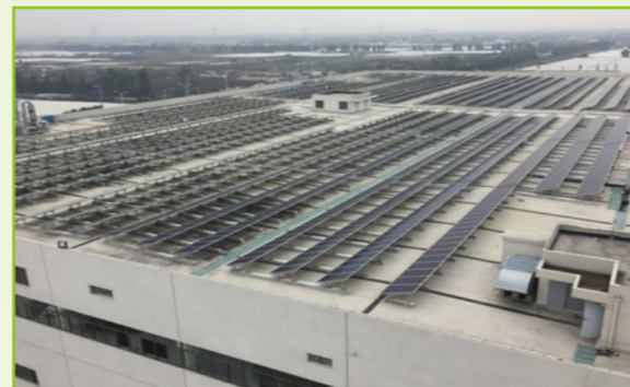
台州滨海 3.8MW
