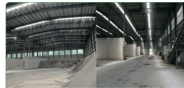
高压喷雾降尘系统
