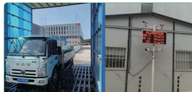
自动车辆冲洗平台、扬尘监测仪
