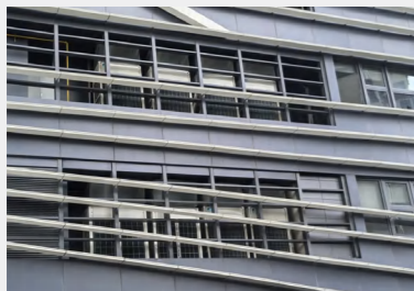
▲ 多聯機室外機佈置
