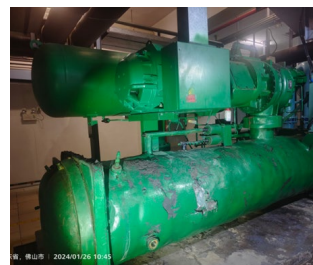
改造前的冷水机组
