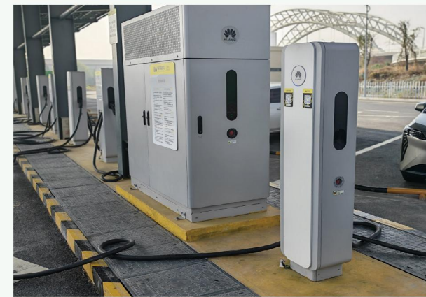
©湖州某能源公司充电桩建设
