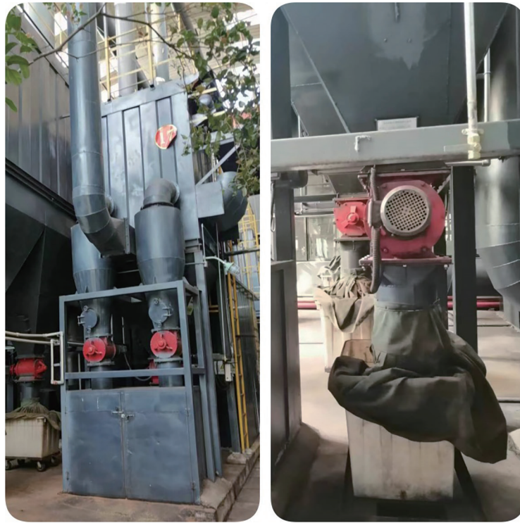
吸塵系統設備
