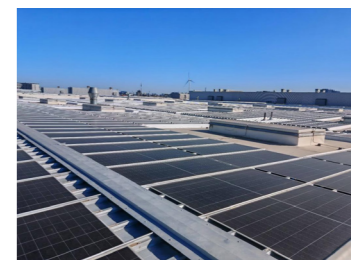
北京奔驰 MRA 厂区光伏
