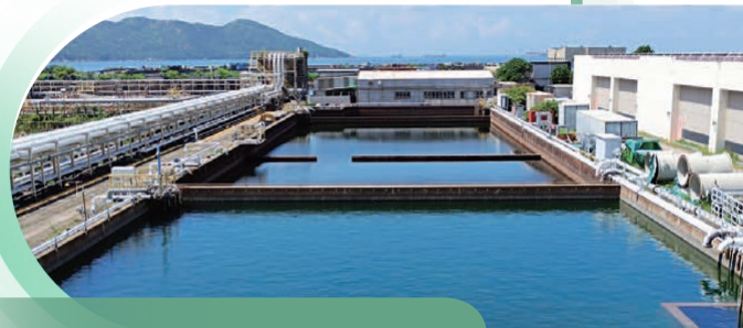
南丫發電廠的雨水和可再用廢水蓄水坑
