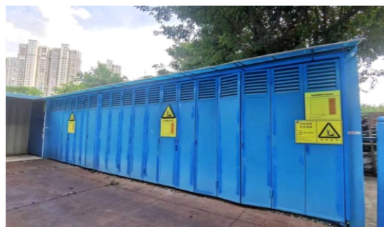
危废收集贮存区
