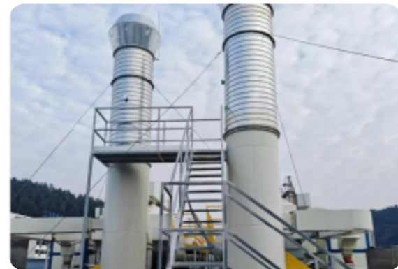
废气处理设备
