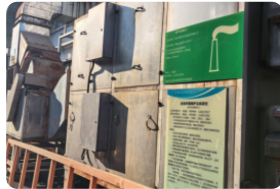
废气处理设备
