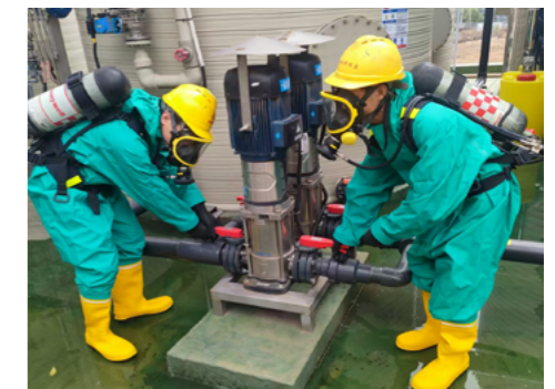
演练中确认硫酸储罐泄漏位置
