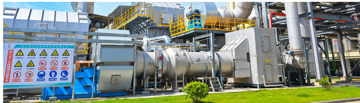
传化合成 RTO 废气处理装置
