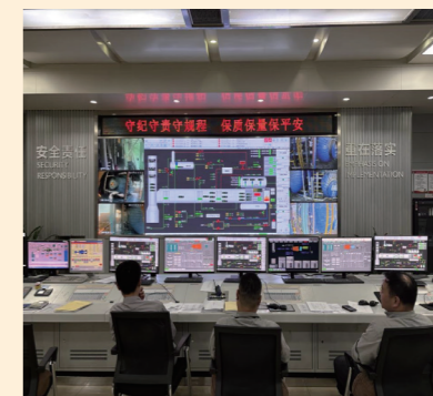
厂区集控室24小时专人值守监盘，实时监控机组运行参数
