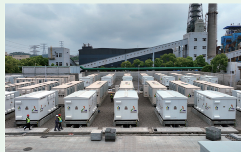
宁波朗辰新能源有限公司光耀50MW/100MWh储能电站项目
