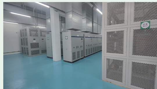
宁波朗辰新能源有限公司大榭16MW/32MWh储能电站项目
