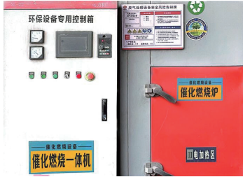
废气处理装置
