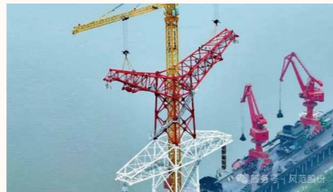
甘肃-浙江±800千伏特高压直流输电工程线路工程(长江大跨越)铁塔
