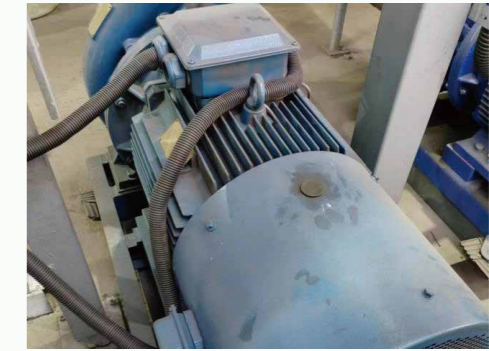
铸锭循环水泵节能技术改造
