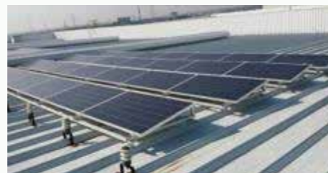
风范股份屋顶光伏发电项目
