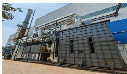
RTO工艺设备
