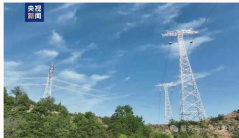
甘肃-浙江±800kV直流线路工程甘肃段，宁夏段
