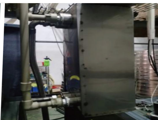
< 空压机余热换热器 >
