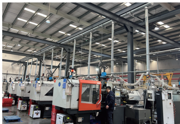
子公司成都瑞联公司注塑废气收集和处理装置
