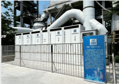
五公司盛鑫厂储能项目
