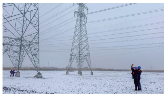
运维人员正在检测线路
