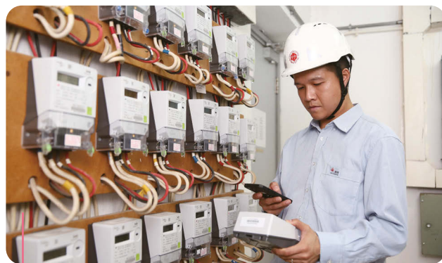
智能電表通訊基礎設施不僅協助客戶有效管理用電，亦讓港燈更清晰掌握電網的狀況，有助提升營運效率和電網管理。
