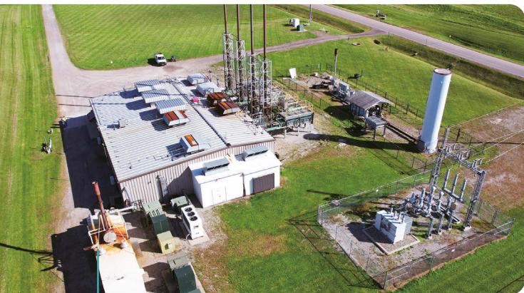
EDL的Brent Run堆填氣體發電站利用密歇根州Montrose附近 Brent Run堆填區回收的甲烷進行可再生能源發電。
