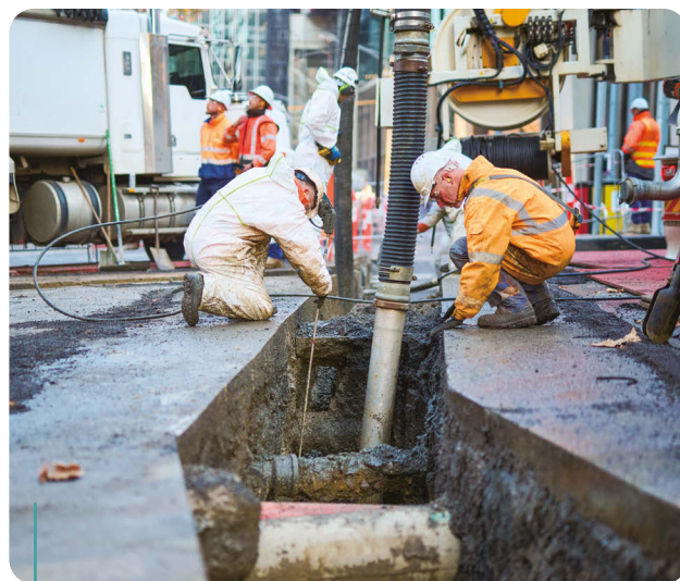
透過 Southbank Jumbo Feeder 項目，VPN 在墨爾本中央商業區及 Southbank 新增三條 11 千伏地底饋線，以提升網絡可靠度、支援新增用戶接駁，並配合 Little Queen 分區變電站的升級工程。
