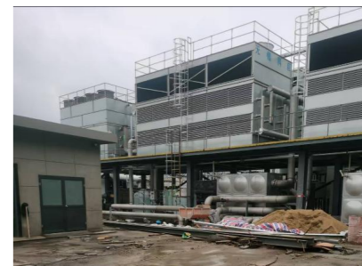
图注：炼钢新改造冷却水循环处置设施
