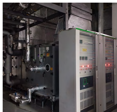
空调新风热回收系统
