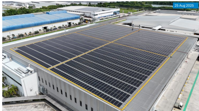
均胜安全泰国工厂光伏项目
