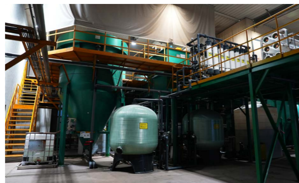
▶ 富奥东机工公司中水回用设备
