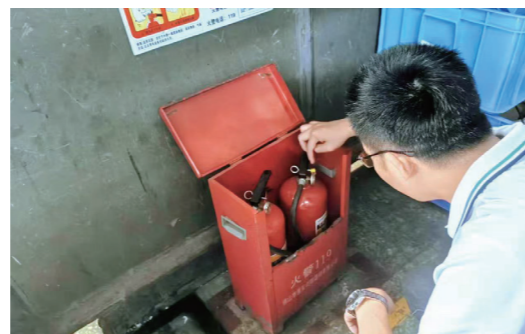
·现场安全隐患排查·
