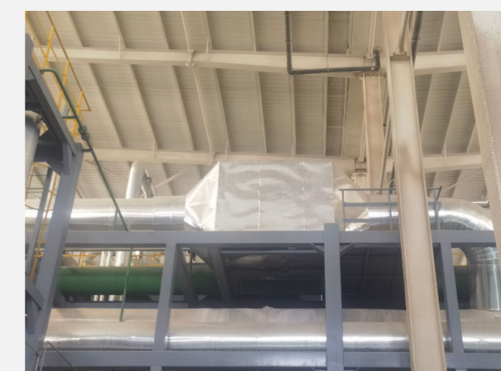
余热回收产蒸汽装置
