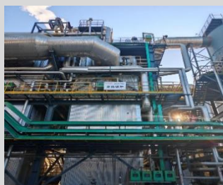
中低温余热回收锅炉
