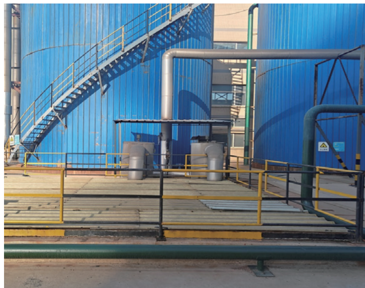
化水站设备冲洗水回用项目
