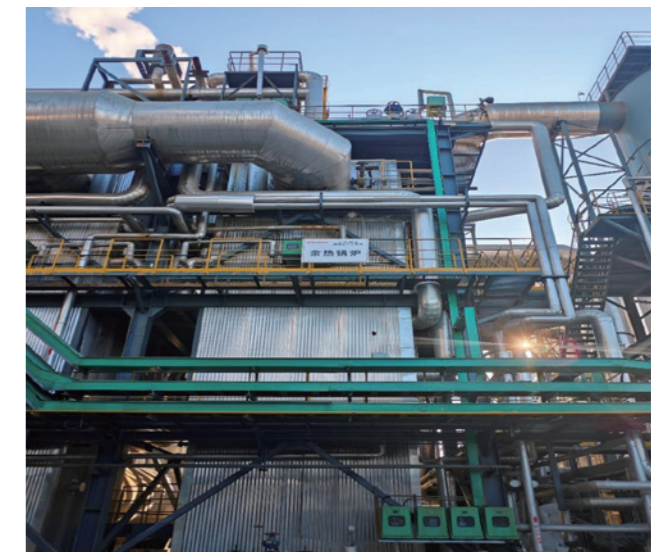
中低温余热回收锅炉
