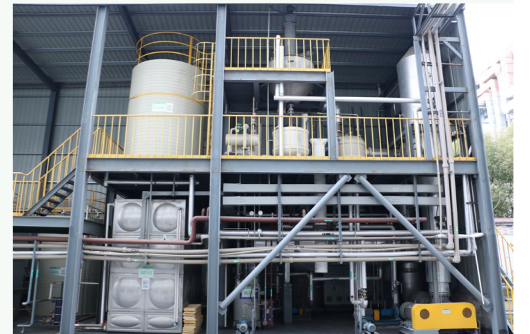
无锡园区生产废水循环利用设施 ▶
