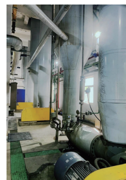
▲ 脱硫废水零排放项目
