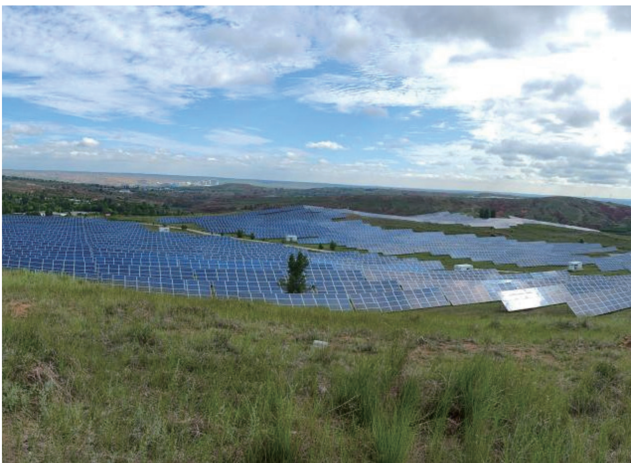
▲ 神木中鸡电站“光伏+荒漠化治理”项目
