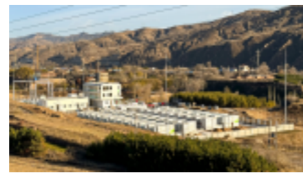
山西偏关混合储能独立调频电站
