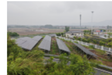
杭绍台高速公路光伏
