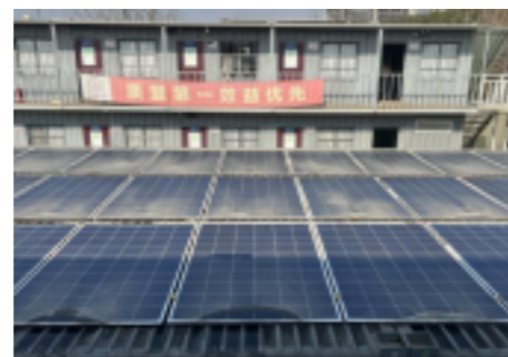
工地可拆卸光伏微电网系统
