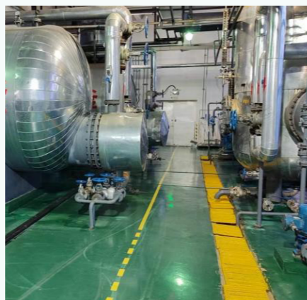
溶媒回收车间
