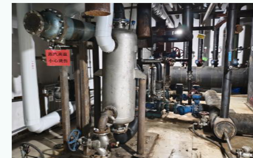
新增换热站自控系统
