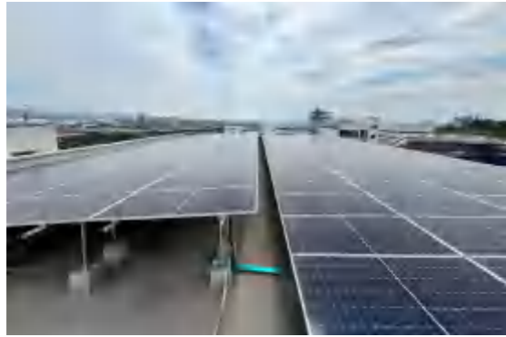
浙江志合屋顶分布式光伏发电装置
