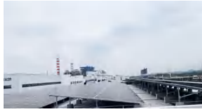
浙江道生屋顶分布式光伏发电装置
