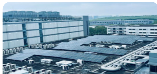
數據中心屋頂光伏
