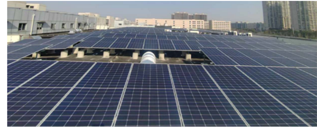
生产厂房光伏设备
