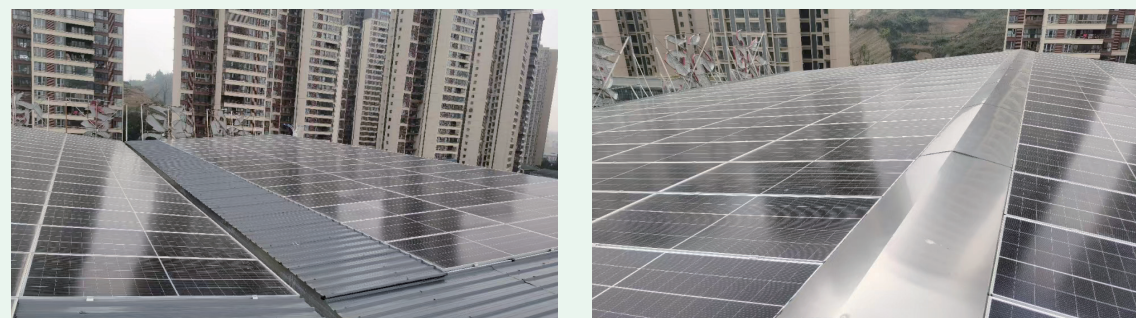
鸿福喜宴中心屋顶光伏
