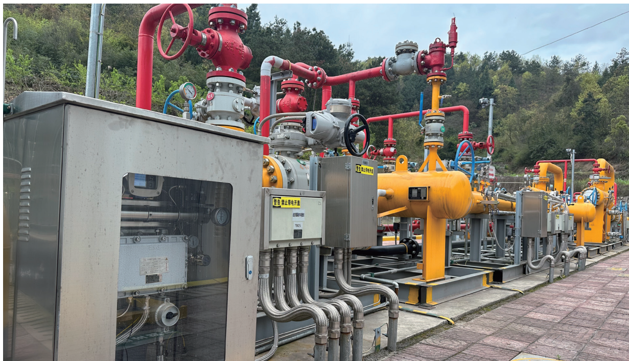
古蔺华远公司彰德调压站智能遥调系统
